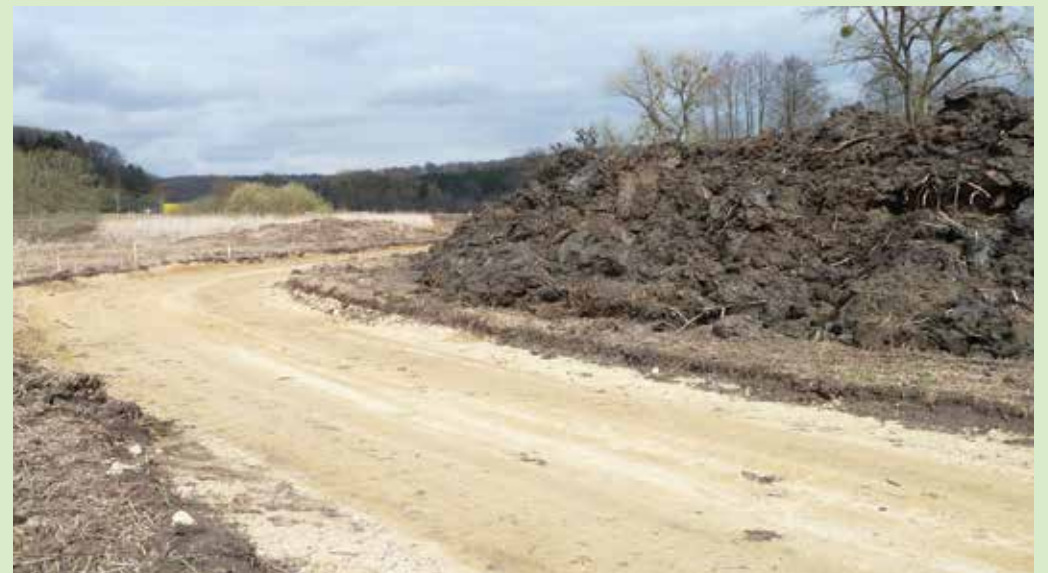
Das Foto zeigt das Ausmaß der Arbeiten, die 2011 vor allem auch auf Intervention des Mouvement Ecologique gestoppt wurden
